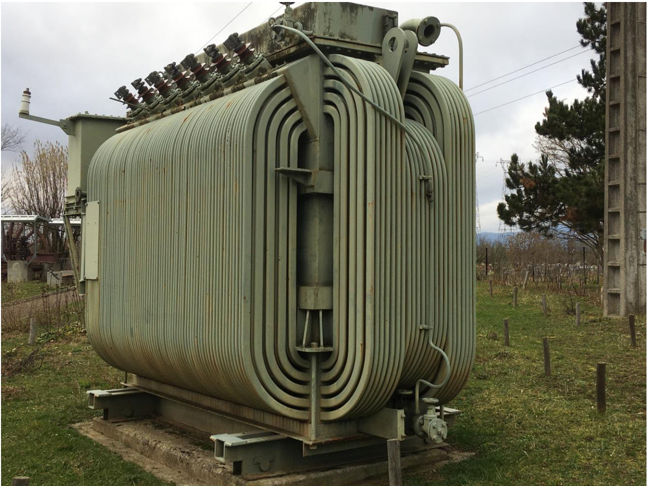
Transformateur de puissance électropolis (Mulhouse fev 2024)
